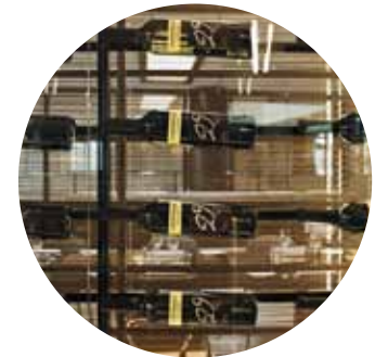
Pannelli in rete metallica e vetro tessuto, inquadrate da cornici verniciate bronzo
